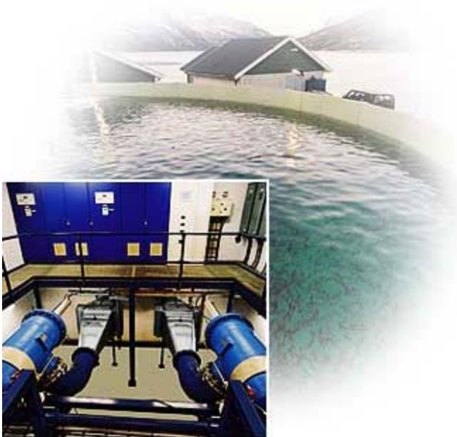
Instalación WEDECO para la desinfección de agua en la piscicultura en Sisomar, Noruega.
